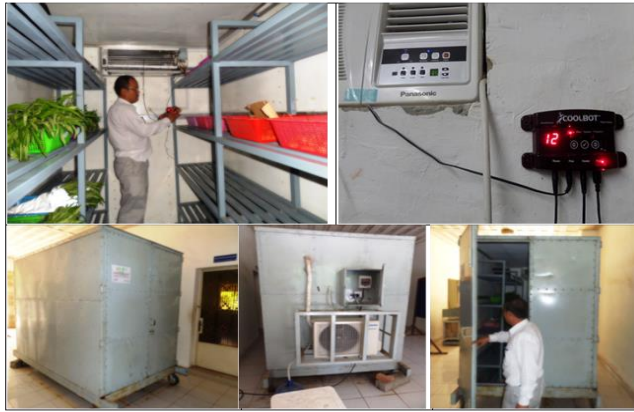
চিত্র ২৪: কুলবোট কোল্ড স্টোরেজে এয়ার কন্ডিশনারের সাথে সংযুক্ত কুলবোট ডিভাইস
