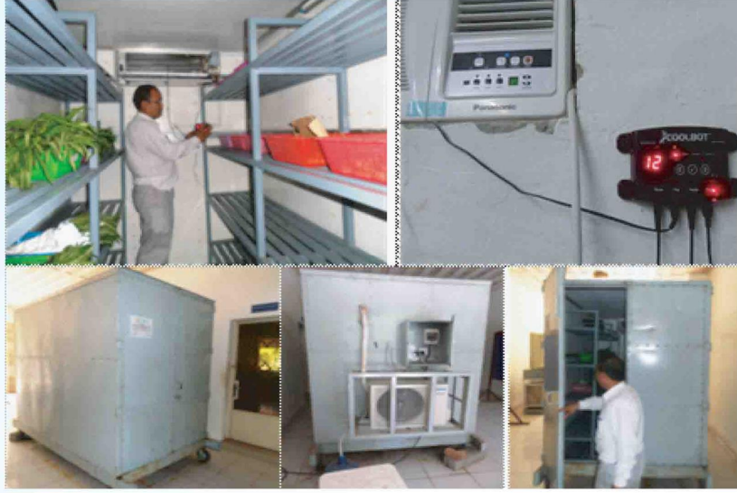
চিত্র ২১ : কুলবোট কোল্ড স্টোরেজে এয়ার কন্ডিশনারের সাথে সংযুক্ত কুলবোট ডিভাইস।
